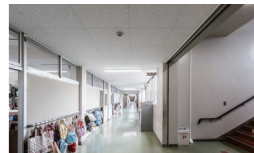
天井材:ロックウール化粧吸音板 ダイロートン 直張ベベル600 耐震天井工法:ダイケンハイブリッド天井
