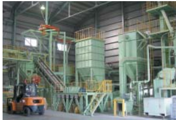
サイディングのリサイクル設備
