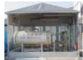
無触媒脱硝設備 排ガス中のNOxを低減
