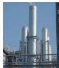
排ガス処理・脱臭装置
