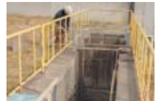
総合排水溝緊急遮断弁閉止
