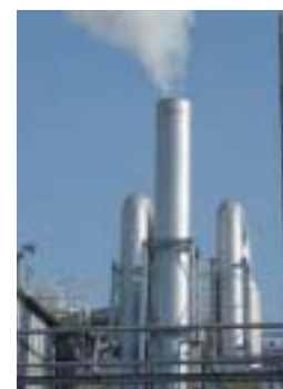
排ガス処理・脱臭装置 排ガスに水を噴霧して不純物を溶解した後、サイクロンでドレインとガスを分離。ドレインは廃水処理場で処理。
