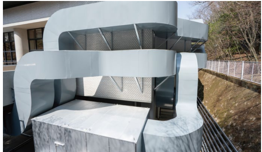
床下ダクトレス全空気式 床輻射冷暖房システム：給気、還気用ダクト
