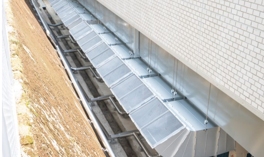
床下ダクトレス全空気式 床輻射冷暖房システム：排気ダクト
