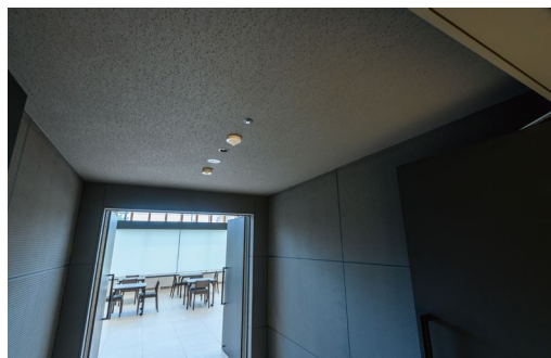
天井材：ロックウール化粧吸音板 ダイロートン メタリック〈トラバーチン（ブラック色）〉
