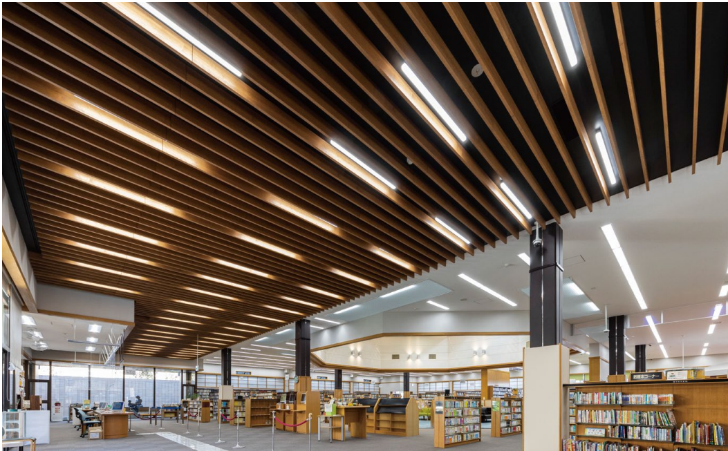
耐震天井工法: ダイケンハイブリッド天井 天井材: ダイロートトラバーチン9mm 天井造作材: グラビオルーバー UB 直付式〈ティーブラウン〉
