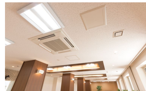
天井材：ロックウール化粧吸音板 ダイロートン トラバーチン9mm（サイズ特注）
