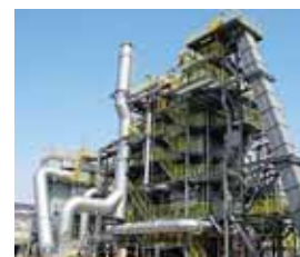
●岡山大建工業(株)で昨年5月に稼働したバイオマスボイラー
