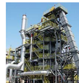
●バイオマスボイラー（岡山大建工業（株））
