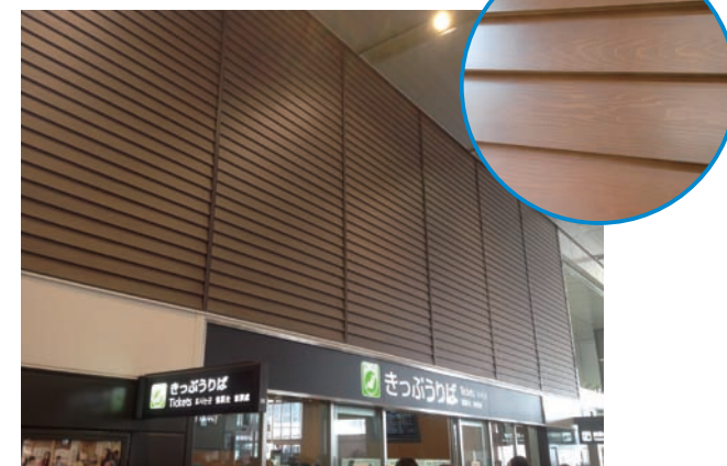
北陸新幹線富山駅の柱・壁に採用された不燃パネル
