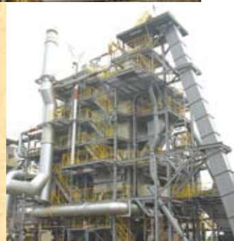
▲岡山大建工業(株)のバイオマスボイラー
