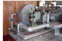
蒸気タービン発電機 木屑ボイラーで発生する蒸気を電気に変換
