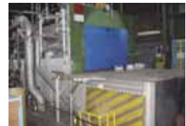
木屑を燃料としたボイラー
