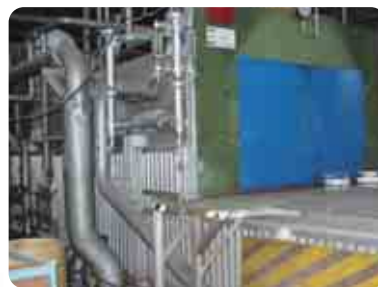
木屑ボイラー
