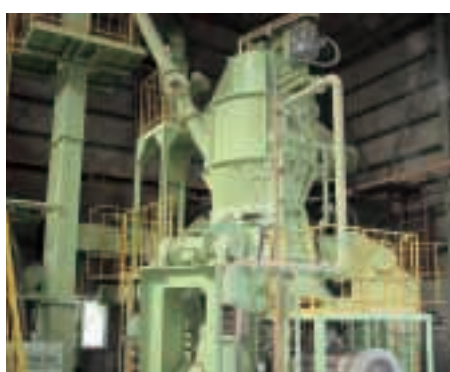
サイディングの リサイクル設備
