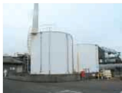
重油タンクの防油堤
