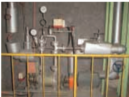
塗装乾燥ラインの蒸気ドレン回収設備
